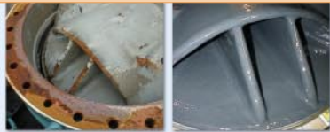
De gecorrodeerde vlinderklep – voor en na reparatie
